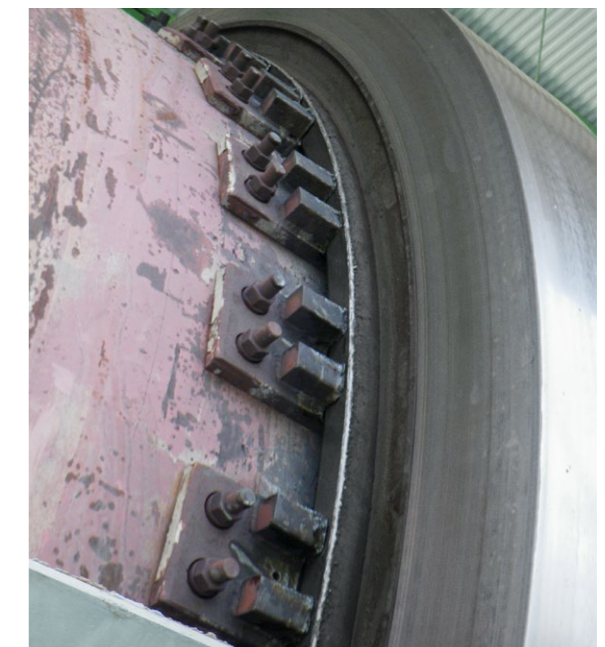
Gut geschmierter Laufring eines Drehrohrofens
